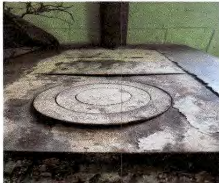
Foto 14: Sustitucion de Plancha de metal de 3 hornillas
